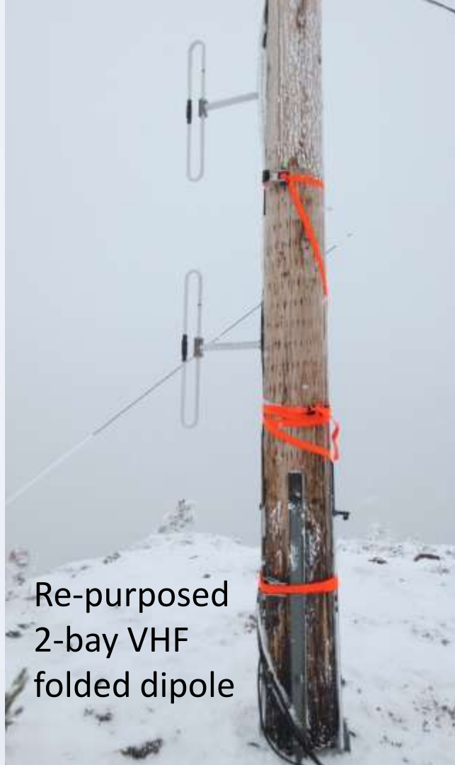
Voila! A new repeater antenna array for VE7RLO!
